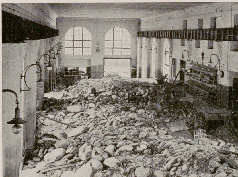
Fig. 13. — La sala de màquines de la Central de Cabdella, després dels aiguats d'octubre del 1937.
