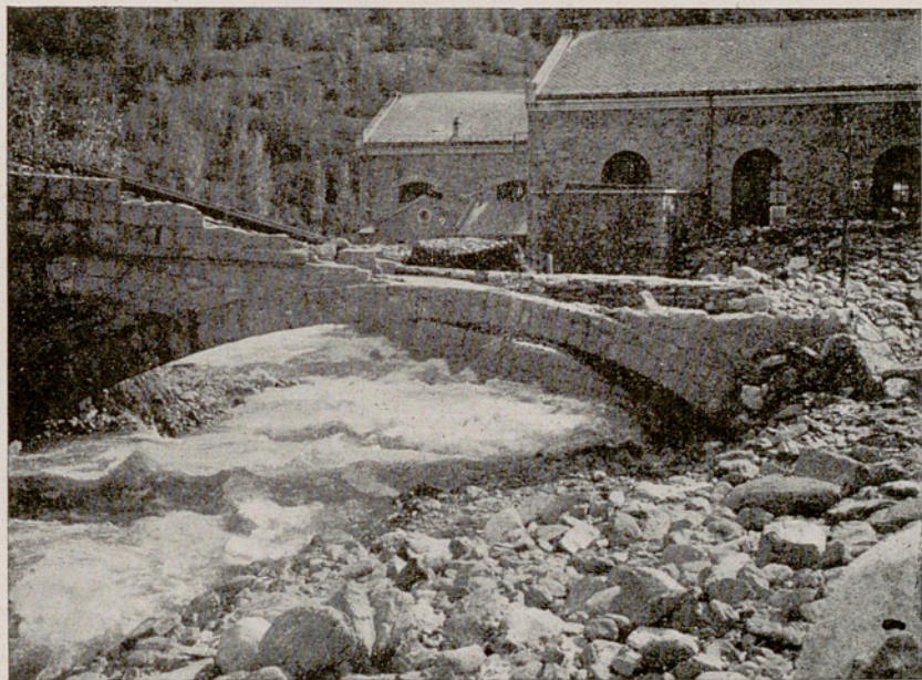
Fig. 15. — La façana nord de la Central de Cabdella, després dels aiguats d'octubre del 1937.
