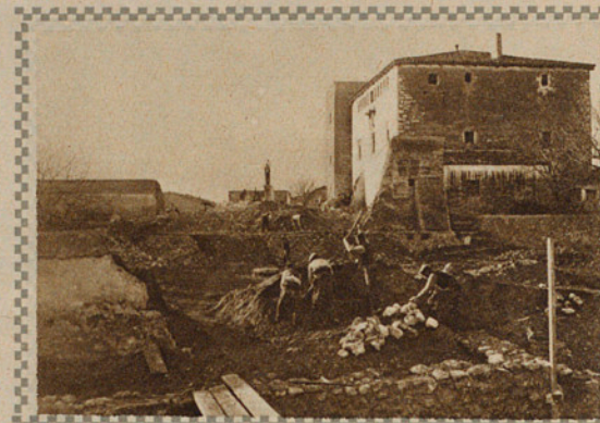
Demolición de Almacenes y cubiertos para dar paso a la Pista Demolició de Magatzems i cuberts per a donar pas a la Pista
