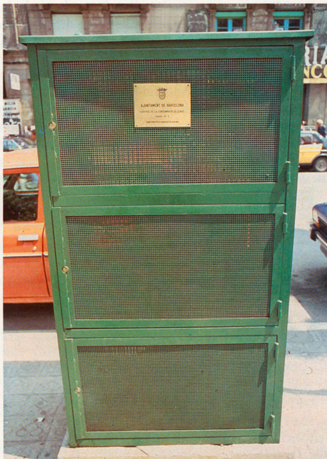
ESTACIÓ DE CONTROL DE LA CONTAMINACIÓ A LA PLAÇA PALAU
